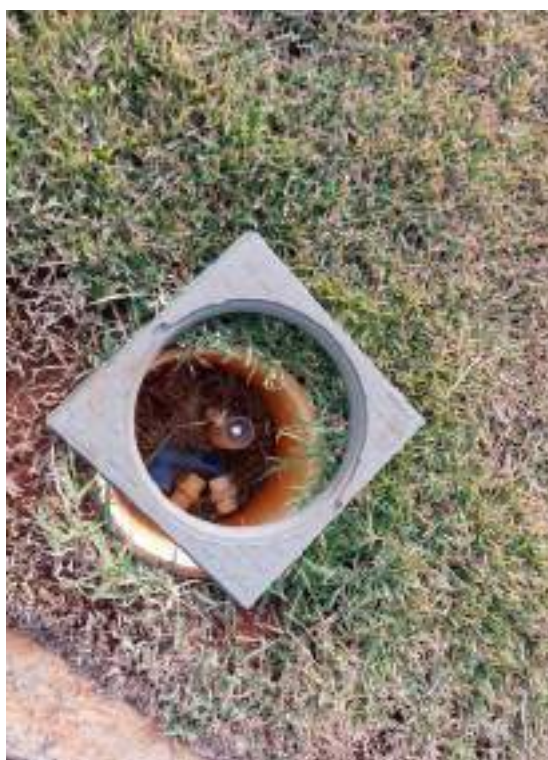
Figura 182: Um dos pontos de distribuição de água da rede de abastecimento de água dos arruamentos do cemitério.
