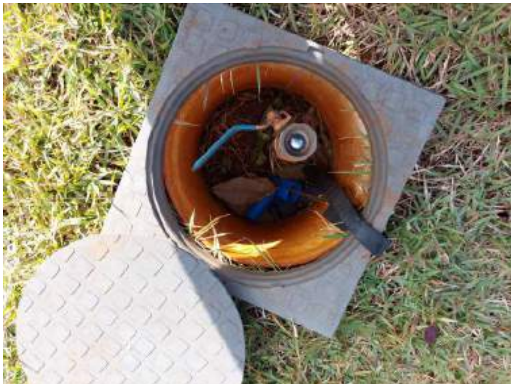
Figura 156: Um dos pontos de distribuição de água da rede de abastecimento de água dos arruamentos do cemitério.
