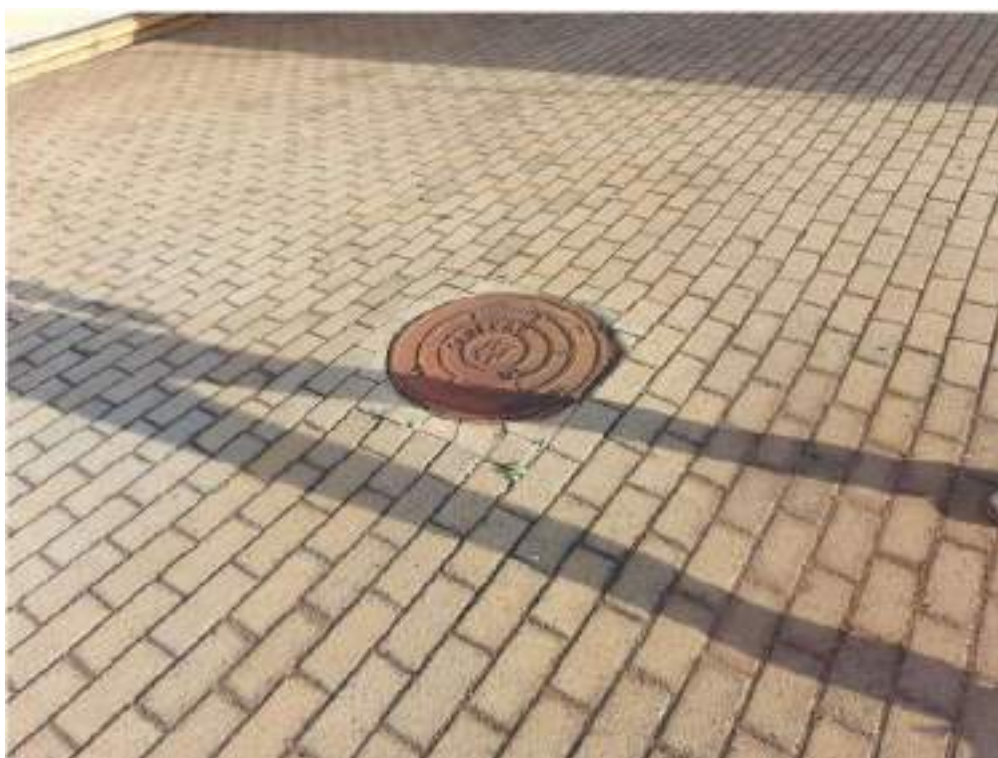
Figura 200: Poço de visita de rede de coleta de águas pluviais.
