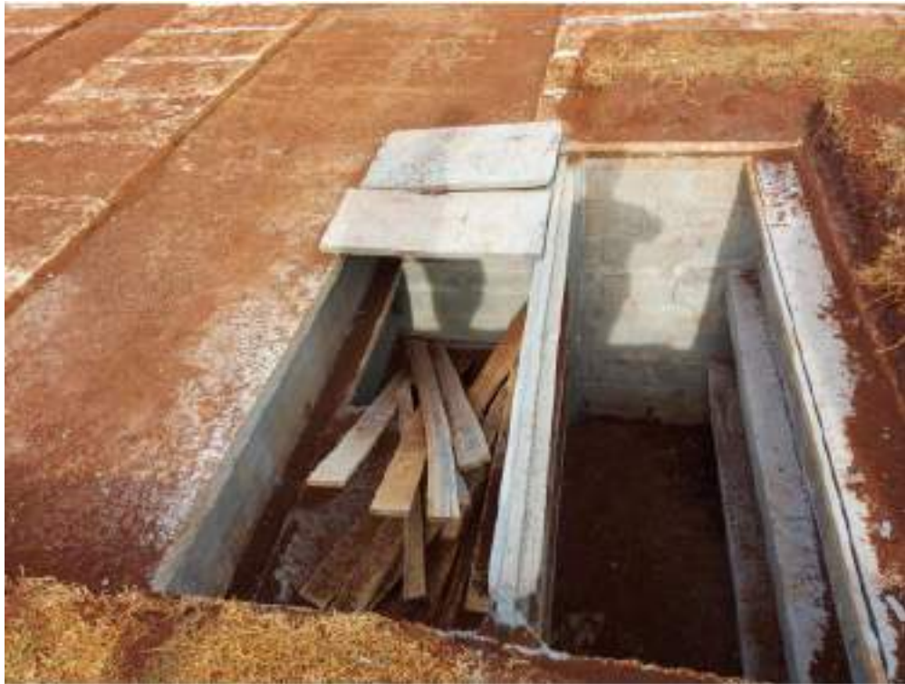
Figura 190: Vista da área com 3 jazigos com acesso que parte estão sendo transformados para 3 gavetas sem acesso.
