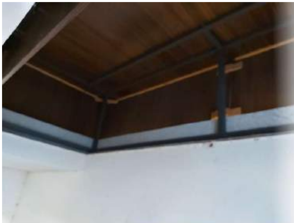
Figura 45: Alçapão de chegada e saída automática do caixão do salão ecumênico, falta apenas instalar o elevador.
