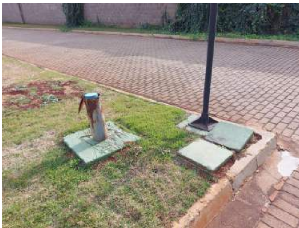
Figura 196: Poço de monitoramento da água subterrânea do lençol freático.
