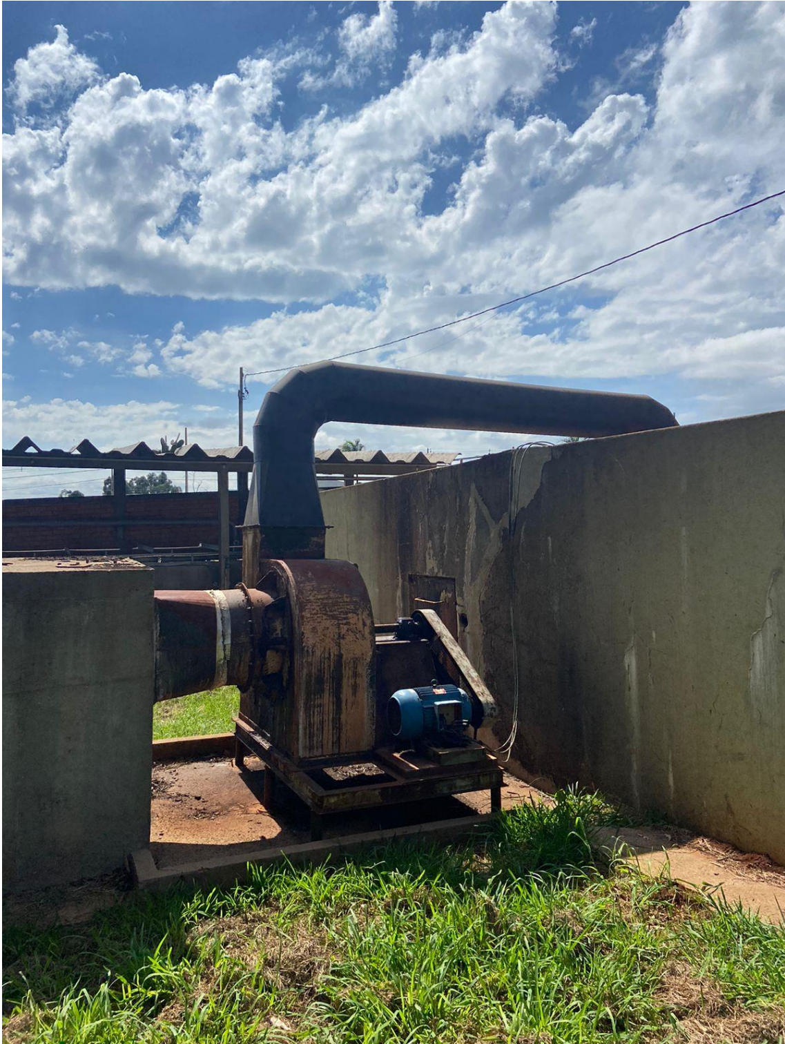
Imagem – 2 Sistema de sucção dos gases para passarem no biofiltro.
